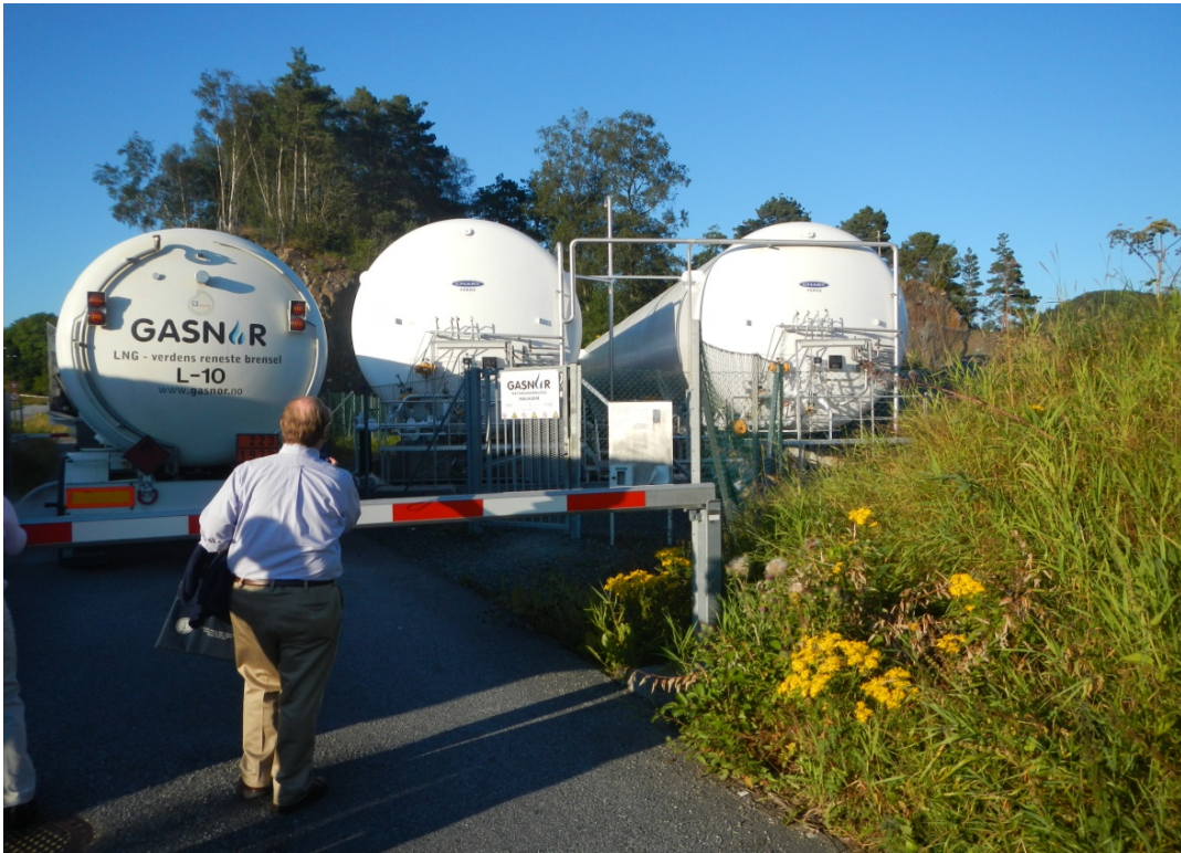
Figure 2 LNG Storage Tanks
